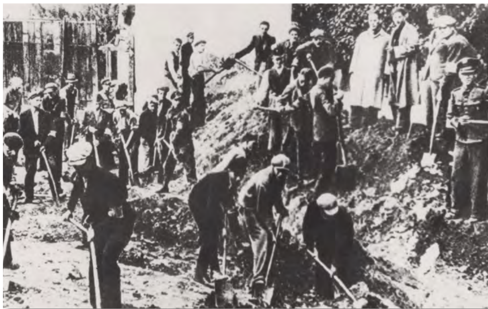
80. Robotnicze Bataliony Obrony Warszawy przy kopaniu okopów w czasie obrony miasta we wrześniu 1939 roku (MN F-3033)
