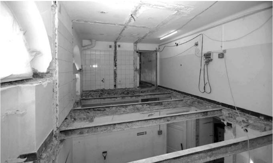
Fot. 4. Nie trzeba też przekonywać, iż niemniej trudną w realizacji była operacja wymiany stropów. Na zdjęciu stalowe legary zastosowane przy odbudowie pałacu, na przełomie lat 40. i 50., dwudziestego wieku.
